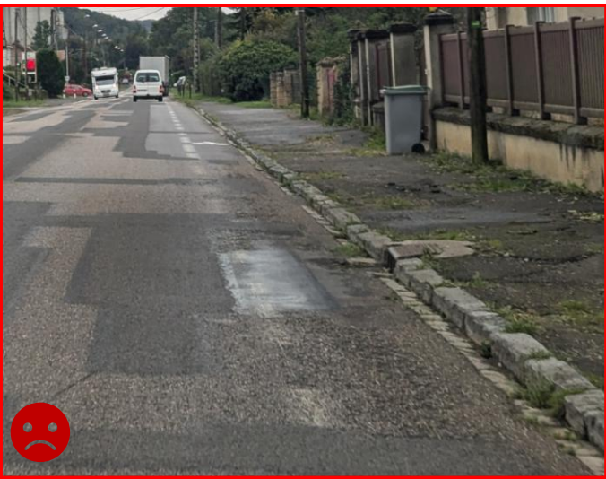
Revêtement en mauvais état pour les bandes cyclables de Montmédy
